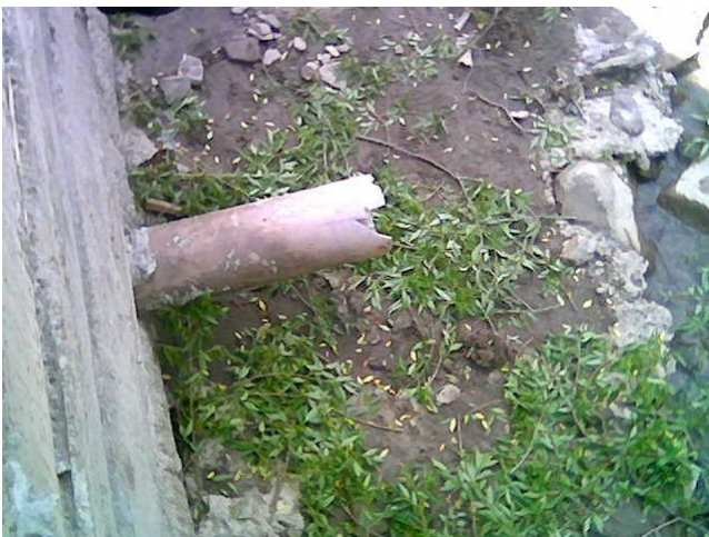
Fig. 2: tubul de acces al apei la senzorul de nivel ramas complet suspendat datorita adancirii albiei si a modificarii curgerii principale pe malul opus
