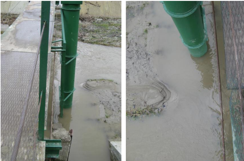
Fig. 1: secțiune de rau cu tubulatura senzorului de nivel puternic colmatata in urma viiturii
