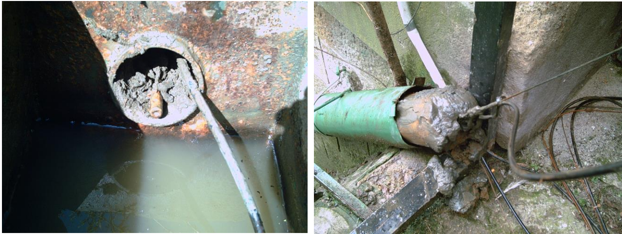
Fig. 3: senzori colmatați în tubulaturii.
